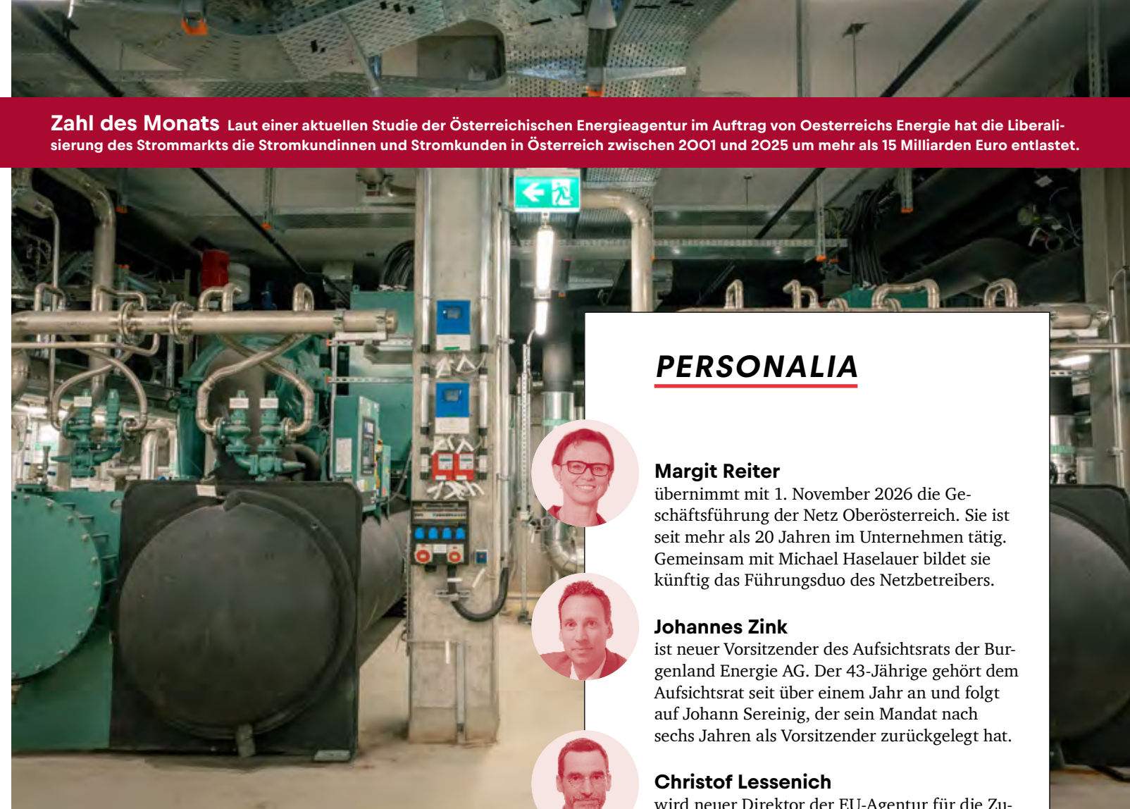
Wien Energie investiert bis 2030 100 Millionen Euro in den Ausbau des Fernkältesystems
