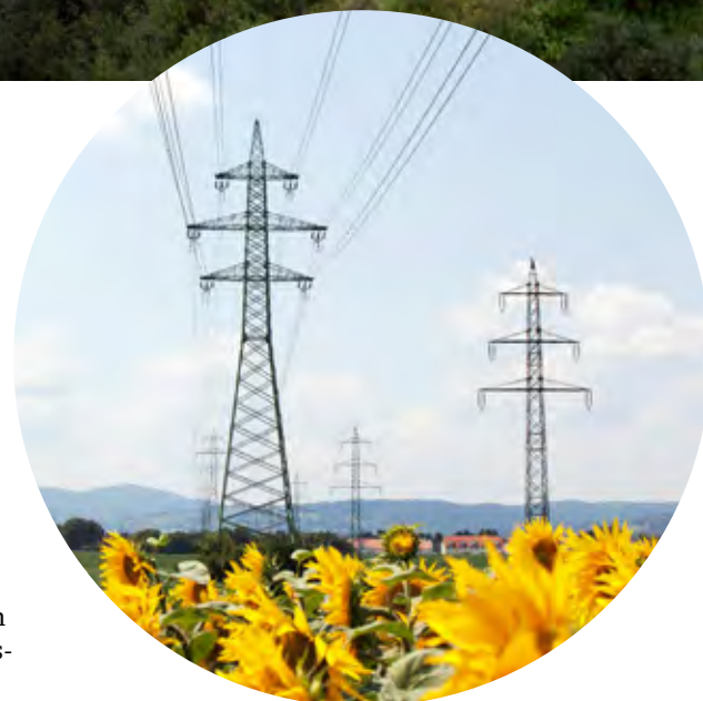
Die Netz NÖ investiert jährlich rund 520 Millionen Euro in ihr Stromnetz, darunter die Leitung bei Bisamberg.
