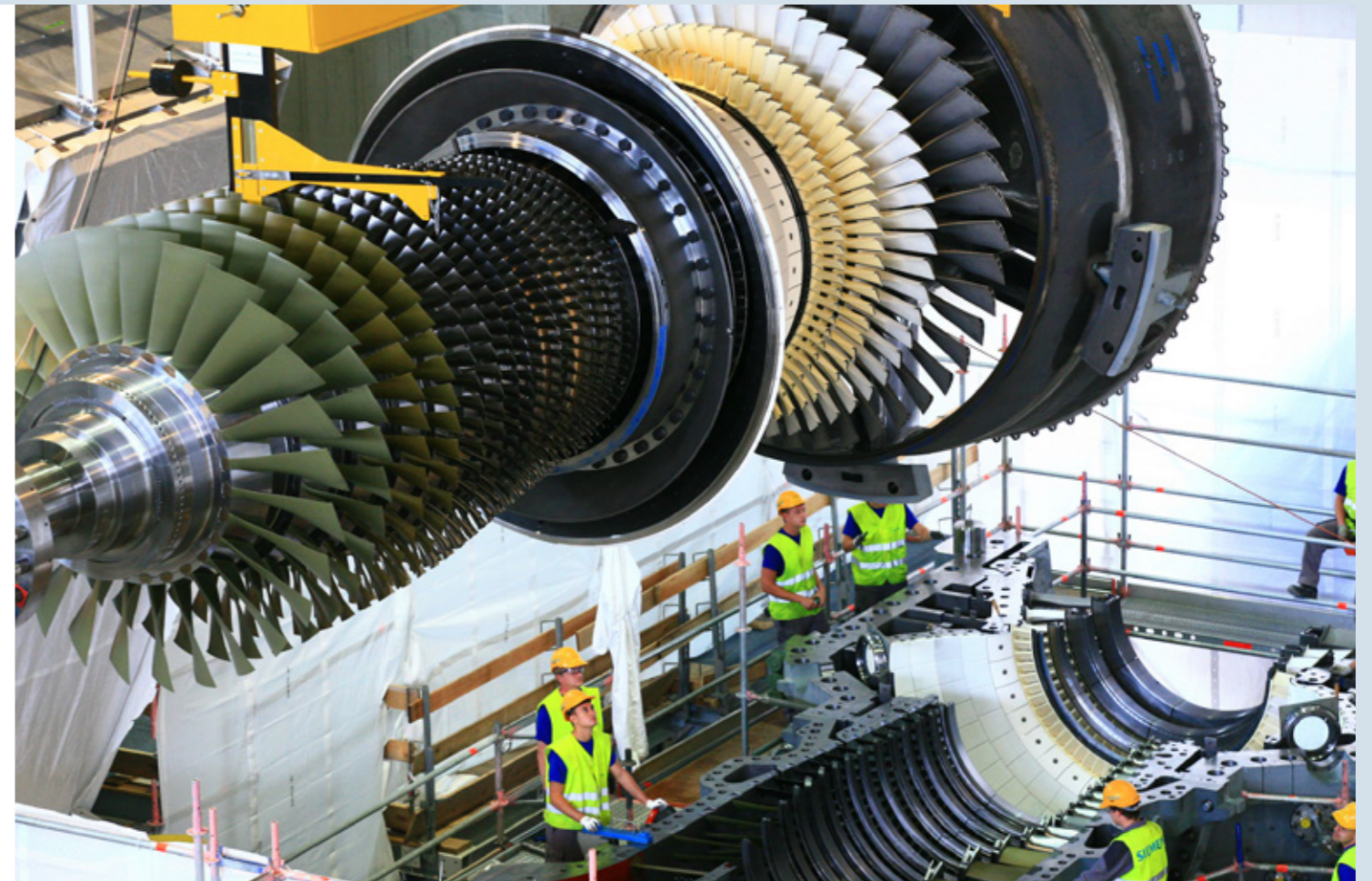
Weiter essenziell: Die APG benötigt auch in den kommenden Jahren die Netzreserve mit hochflexiblen leistungsstarken Gaskraftwerken zum sicheren Management ihrer Infrastrukturen und damit zur Aufrechterhaltung der Versorgungssicherheit.
