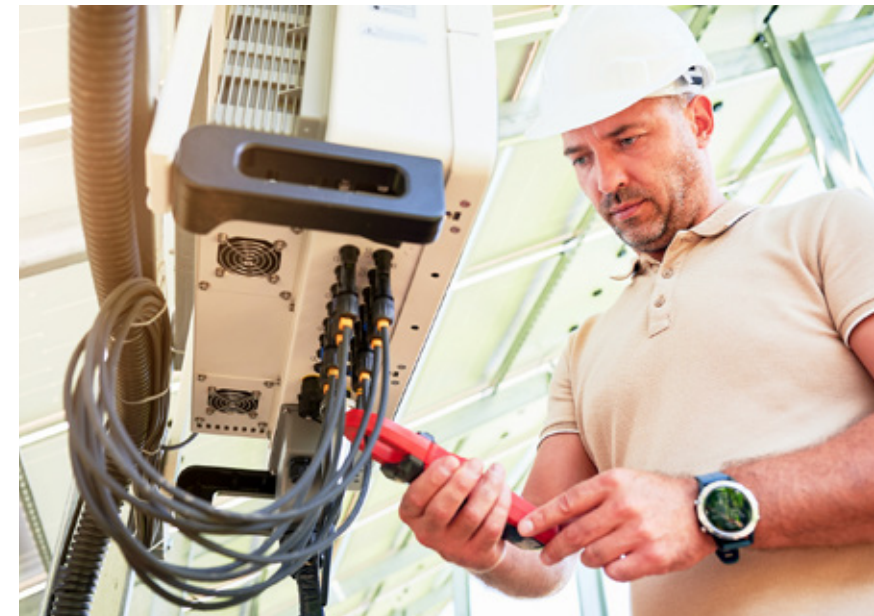
Den Wechselrichter so einzustellen, dass die PV-Anlage ordnungsgemäß funktioniert, ist nicht einfach.
