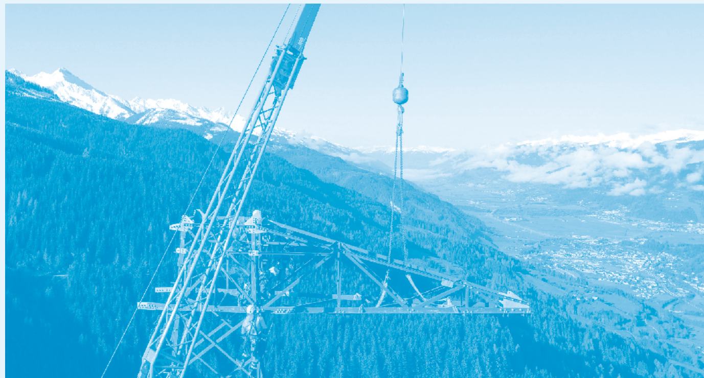
Zu niedrig angesetzte grüne Neuinvestitionen könnten zu einem verzögerten Ausbau der Netze führen.
