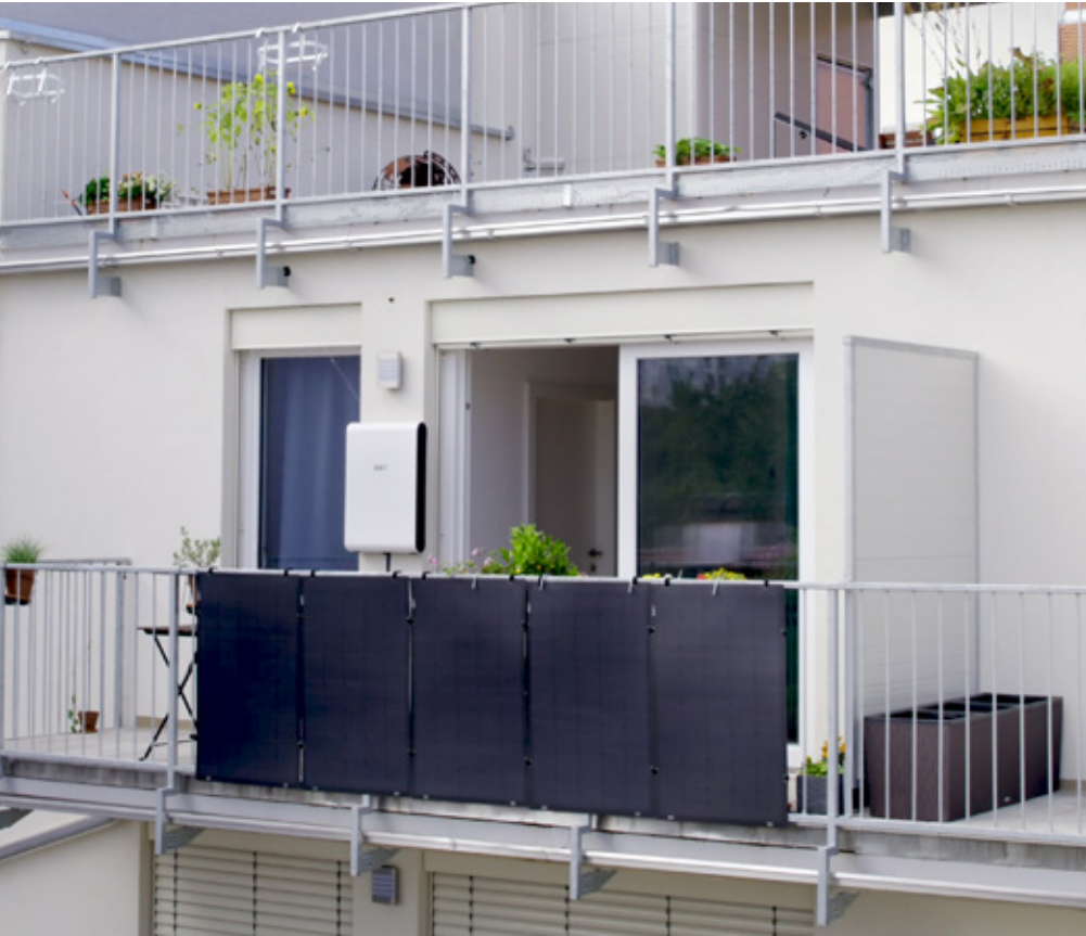
Plug and Play: PV-System zu entwickeln, bei dem die Messtechnologie direkt im Speicher verbaut ist
