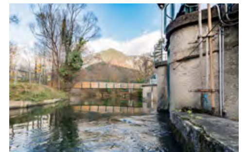
Beständigkeit der Energiegewinnung: Wo sich früher große Mühlsteine drehten, arbeitet jetzt eine Turbine zur Stromgewinnung.
