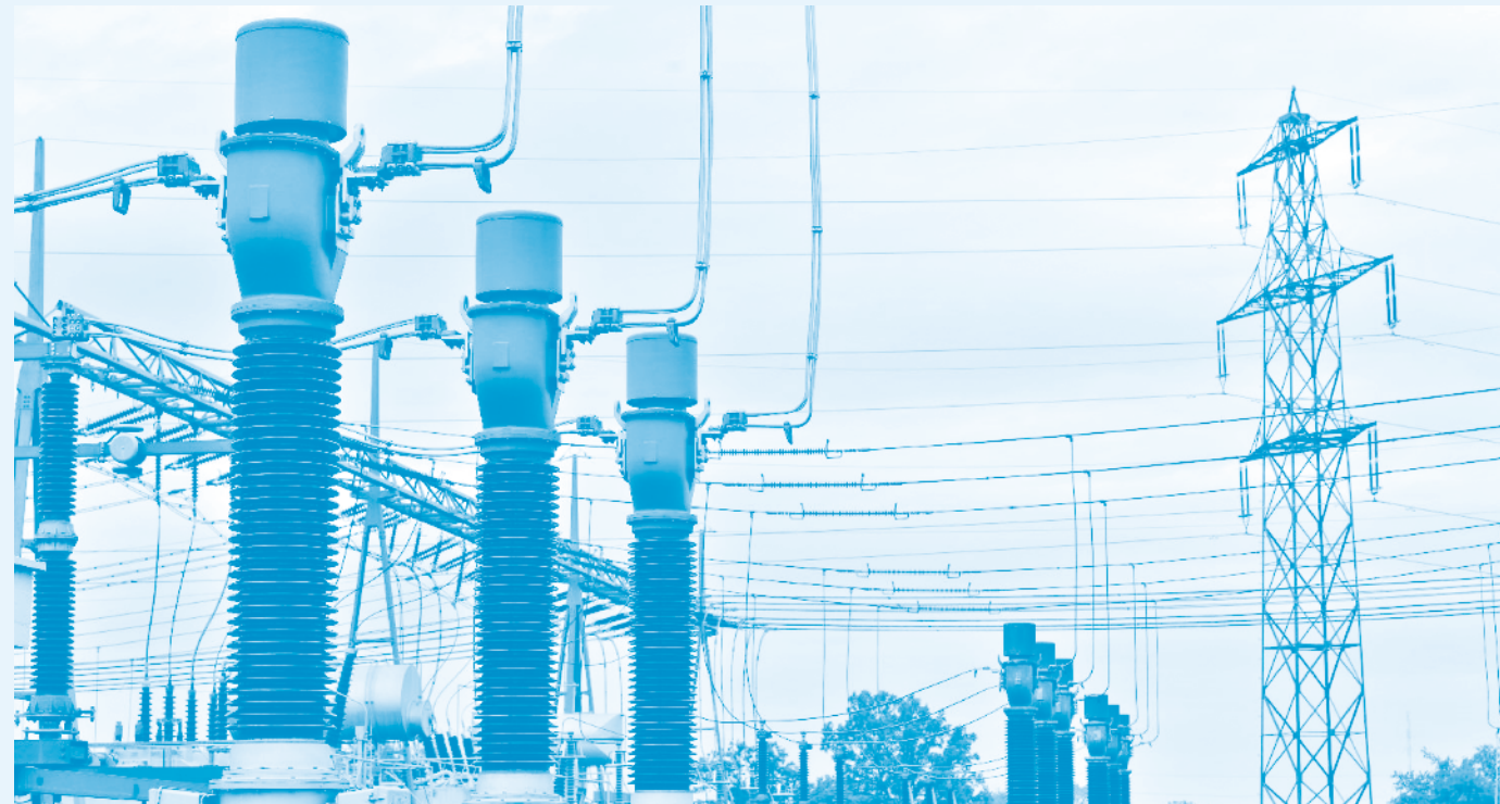
Zustandsüberwachung bei Messwandlern: Studie gibt Einblick in Fehlererkennung
