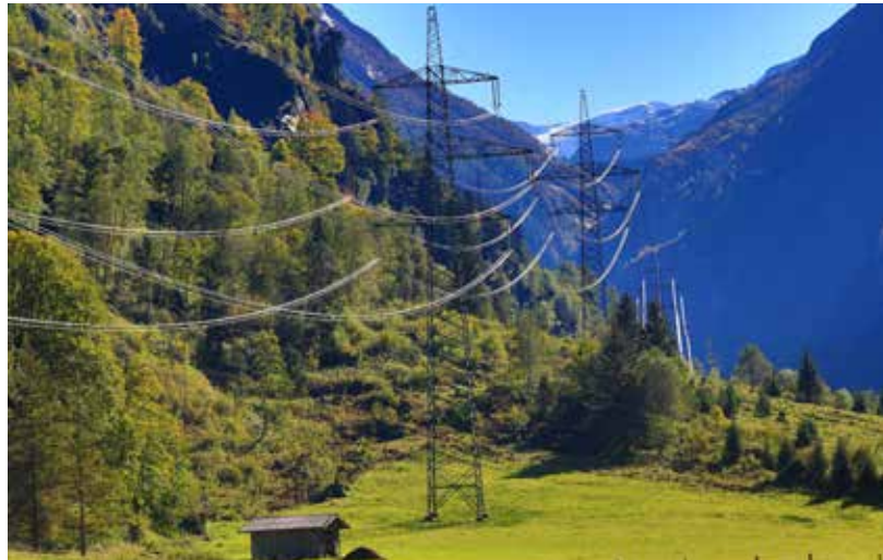
Oesterreichs Energie/Christian Fischer
