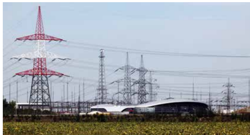
Oesterreichs Energie/Christian Fischer
